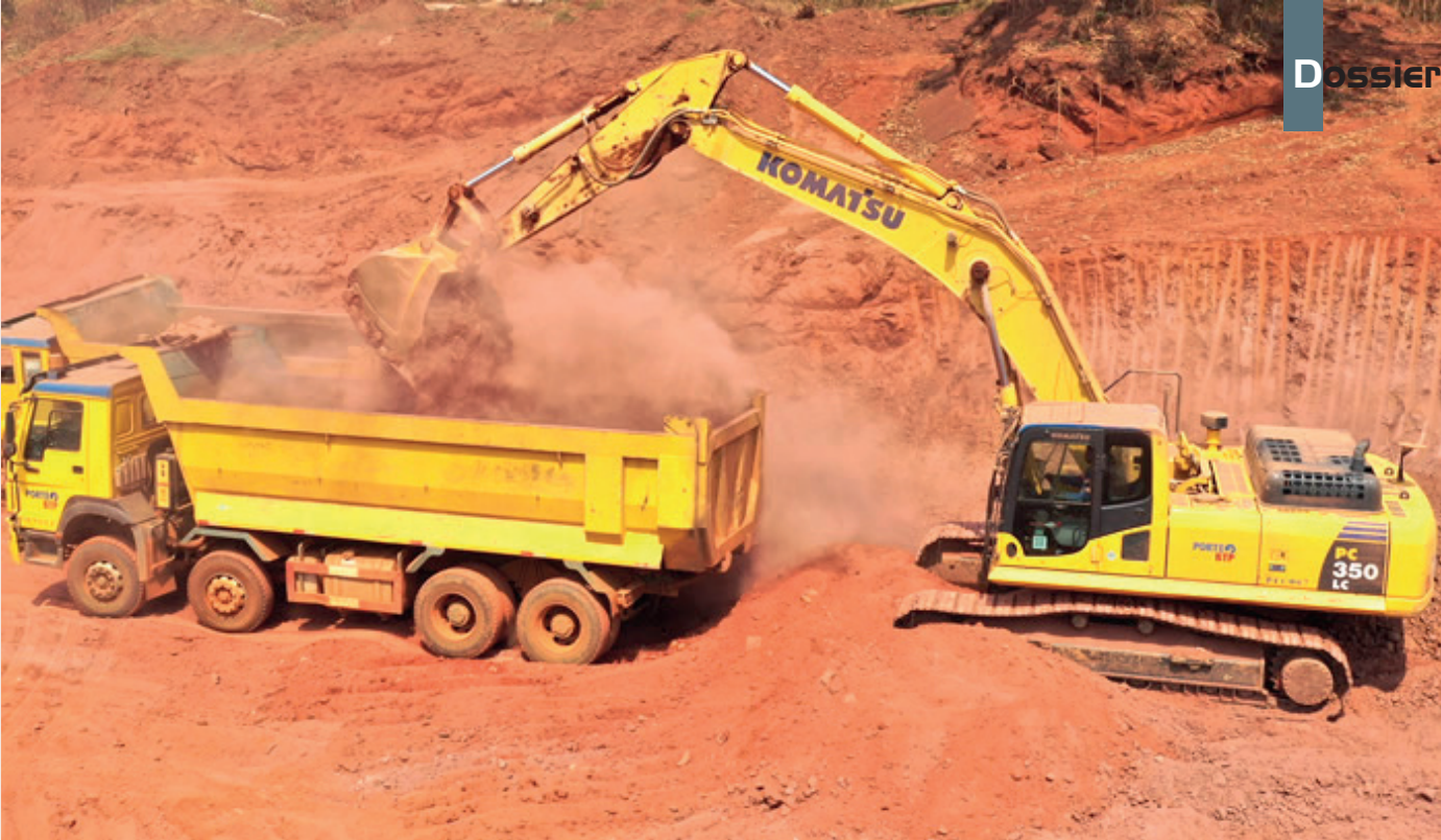
Excavation et transport de terre par une entreprise locale sur un chantier en Afrique subsaharienne
